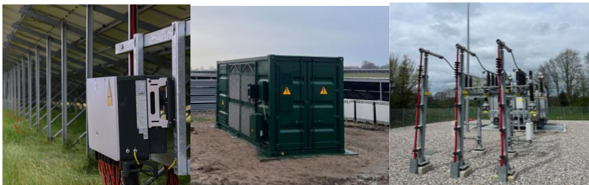
Figur 4: Venstre: Inverter - placeres bag solceller. Central: Transformerstation – Mellemspænding. Højre:Transformerstation – Højspænding
