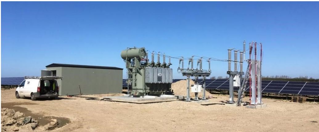
Figur 3 Eksempel på stepup-transformer og teknikbygning.
