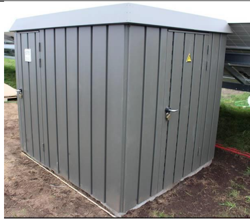
Fig. 10: Eksempel på step-up transformer
